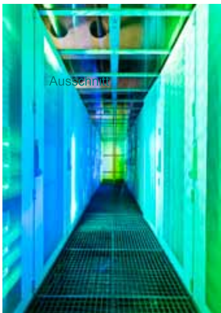
Kaltgang des neuen Serverraums
